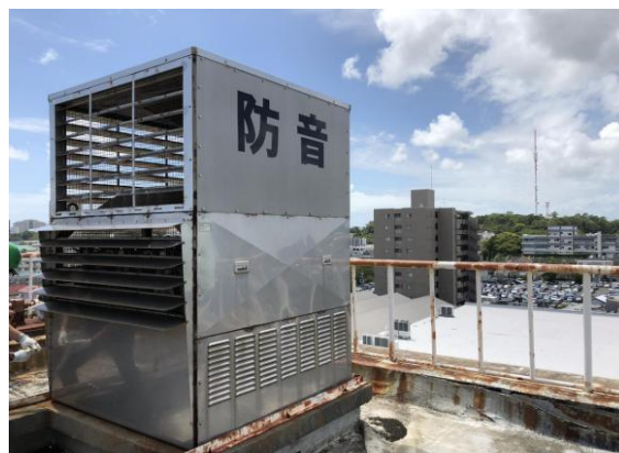
図3 ミュージックサイレンの周囲を覆う防音版
